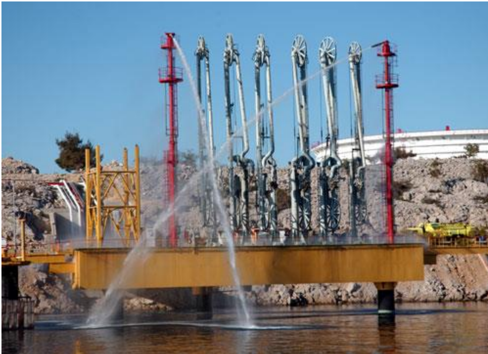
Slika 20. Vatrogasni monitori na vezu terminala u Omišlju
