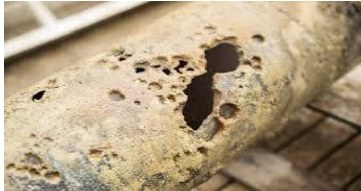
Slika 14. Rupičasta korozija (Izvor: https://www.nuflowmidwest.com )
