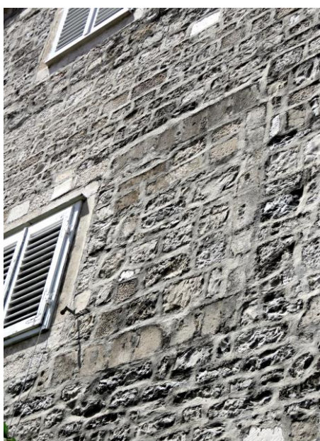
Slika 45. Zazidani prozor prvog kata sjevernog samostanskog krila
