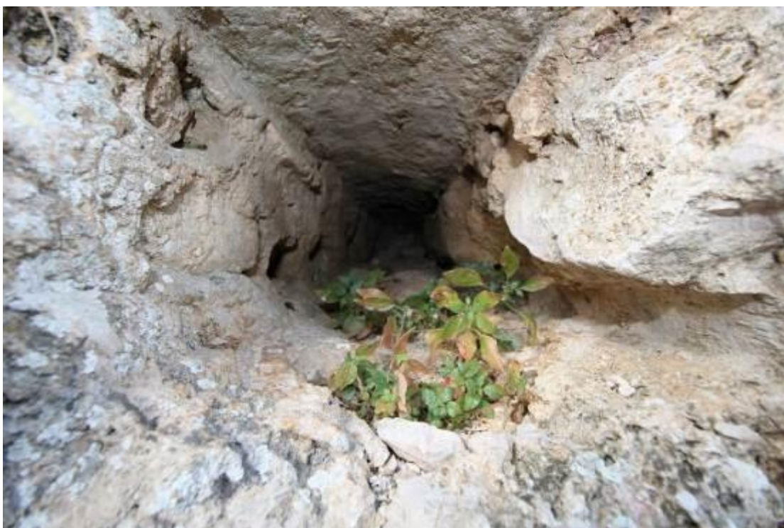
Slika 35. Vrlika – Prozor, šupljina od grede unutar zida
