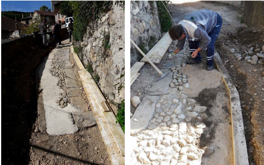
Sl. 277. a - b Provođenje radova konzervacije na prvom dijelu popločenja (kaldrme) (foto: Miloš Biserko, 2017.)
