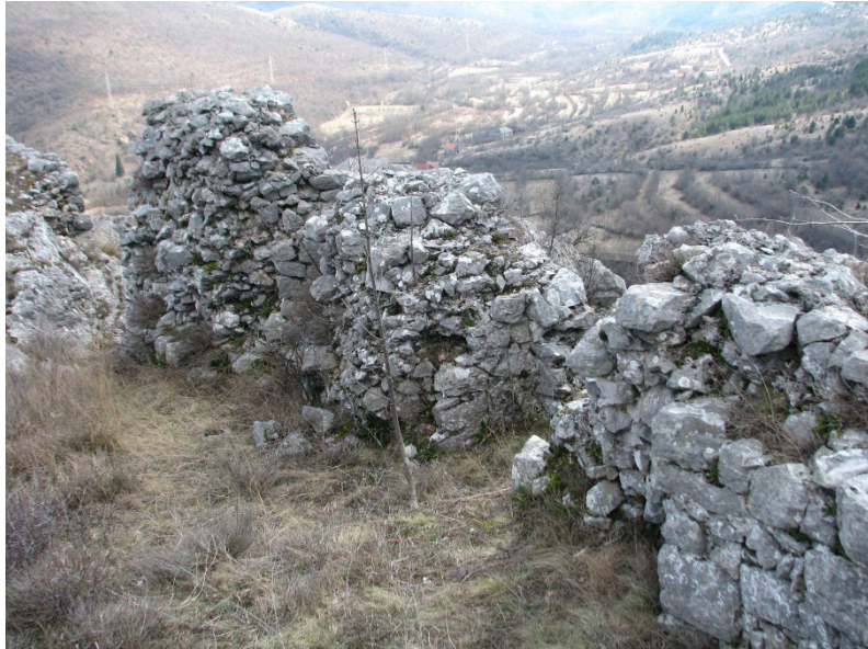
Sl. 347. Ostatak obrambenog zida na jugoistočnoj strani
