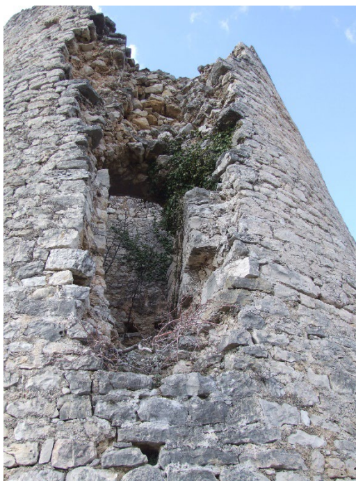
Sl. 138. Ostatak prozora i u produžetku oštećenja na jugozapadu kružne kule
