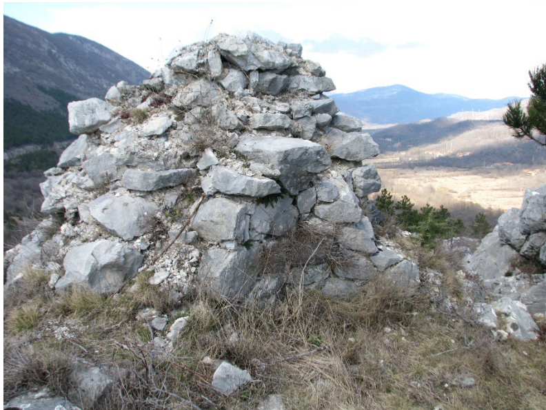
Sl. 348. Ostatak obrambenog zida na jugoistočnoj strani
