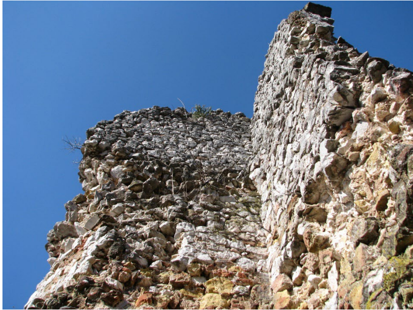
Sl. 402. Pogled s jugozapada na oštećenje pri vrhu pravokutne kule
