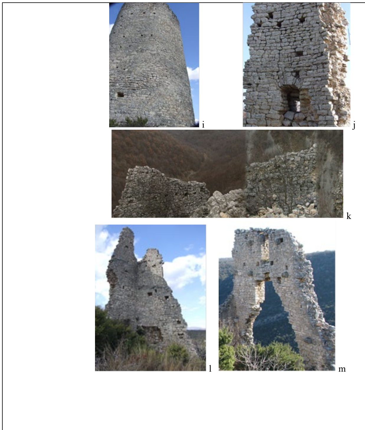
Sl. 461.a-m Otvori za nosivu konstrukciju greda na srednjovjekovnim i novovjekovnim utverdama
