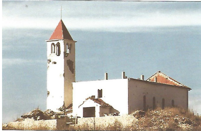
Slika 30. Podgradina- Župna crkva sv. Duha. (Ranjena crkva u Hrvatskoj, 1996: 296).
