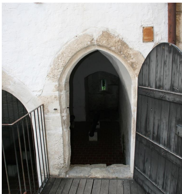
Slika 9: Varaždin, Stari grad – sjeverna kvadratna kula, kameni okvir vrata (fotografija: Ivana Peškan)
