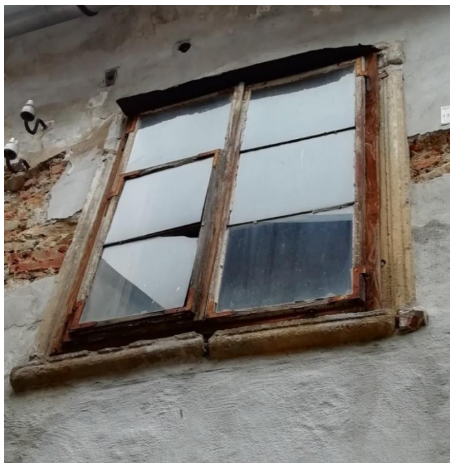
Slika 49: Varaždin, Trg slobode 6 – kameni okvir prozora (fotografija: Ivana Peškan)
