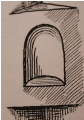
Prilog 47. Primjer niše, udubine na unutrašnjoj strani zida (vjerojatno je služila za odlaganje)
