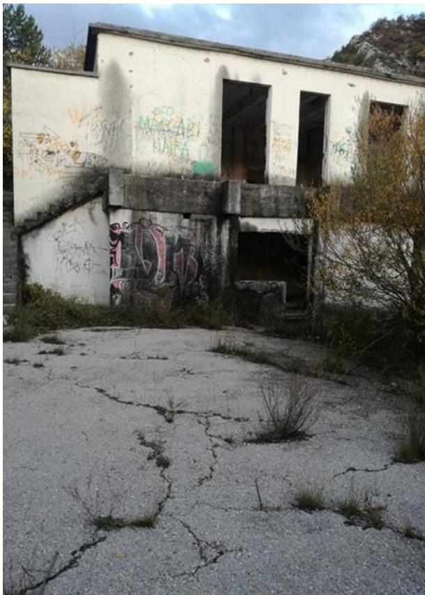
Slika 17. Trenutno stanje postojećeg devastiranog objekta
