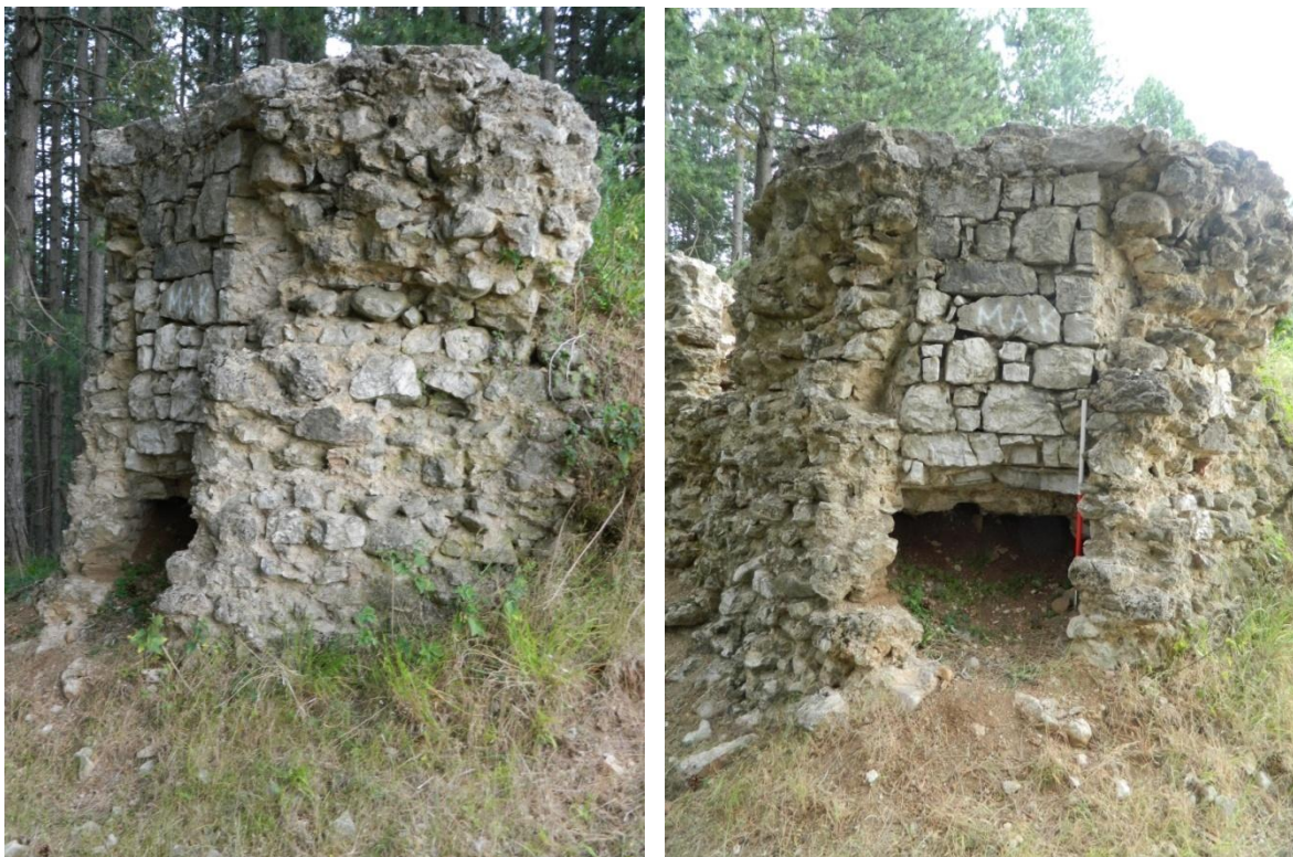
Slike 158 i 159: Ruševine na položaju Grad – Knežak, pogled na ostatak zidova sa južne strane (foto: N. Čuljak).
