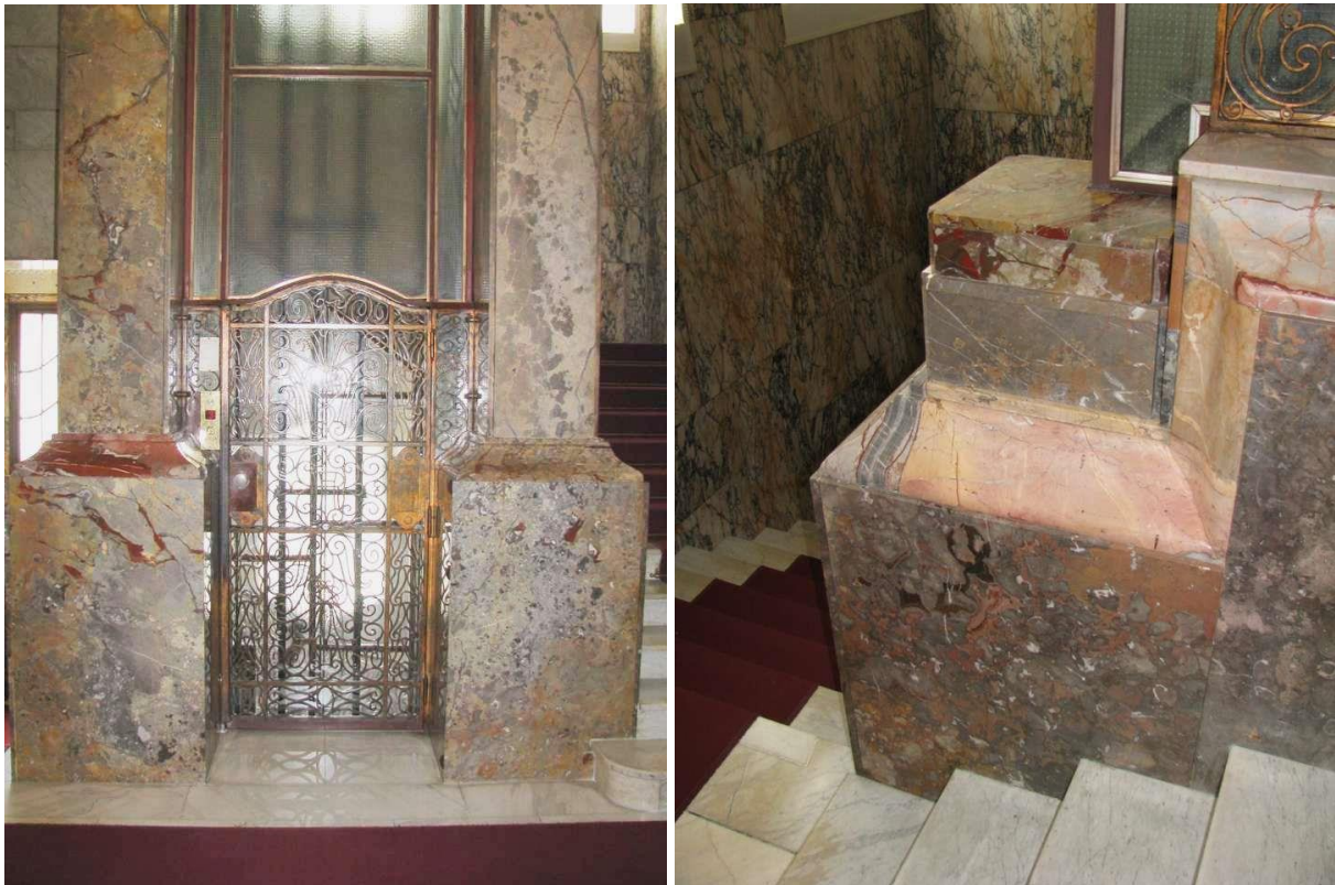
105. i 106. Adaptacija stubišta palače Vranyczany (Zagreb, Trg Nikole Zrinskog 19), ulaz u dizalo i detalj stubišta (foto: M. Strugar)
