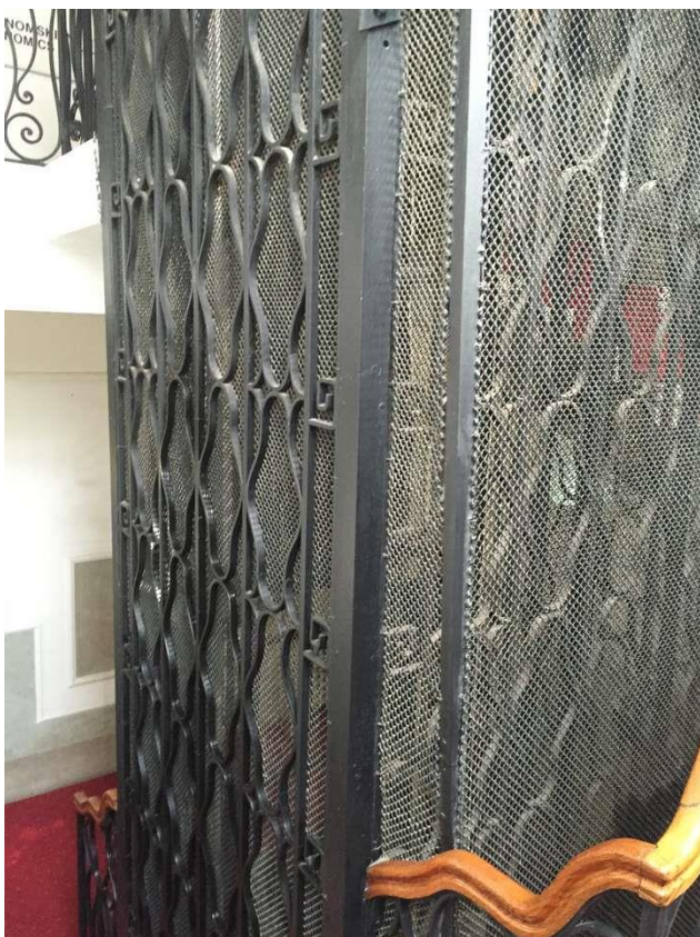
437. Dom Činovničke zadruge (Beograd, Kralja Milana 16/Dobrinjska 11), dizalo u dijelu zgrade u Ulici kralja Milana (foto: A. Koprčina, 2015.)
