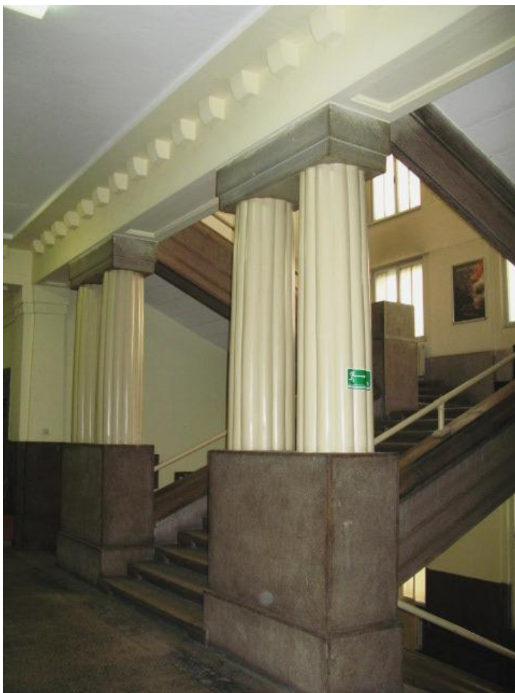
90. Kraljevski sveučilišni ludžbeni zavod (Zagreb, Marulićev trg 20), glavno stubište, detalj (foto: M. Strugar, 2012.)
