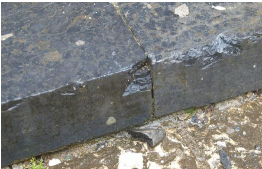
Sl. 126 Oštećenje na podestu fontane Vrela života nastala 2014. g. (Fototeka GMD)
