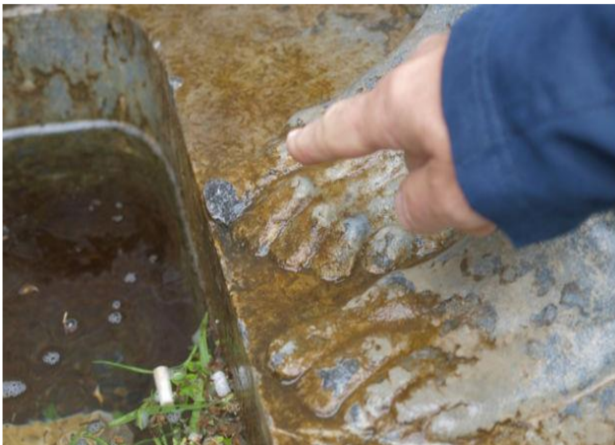
Sl. 125 Oštećenja na fontani Vrela života nastala 2014. g. (Fototeka GMD)
