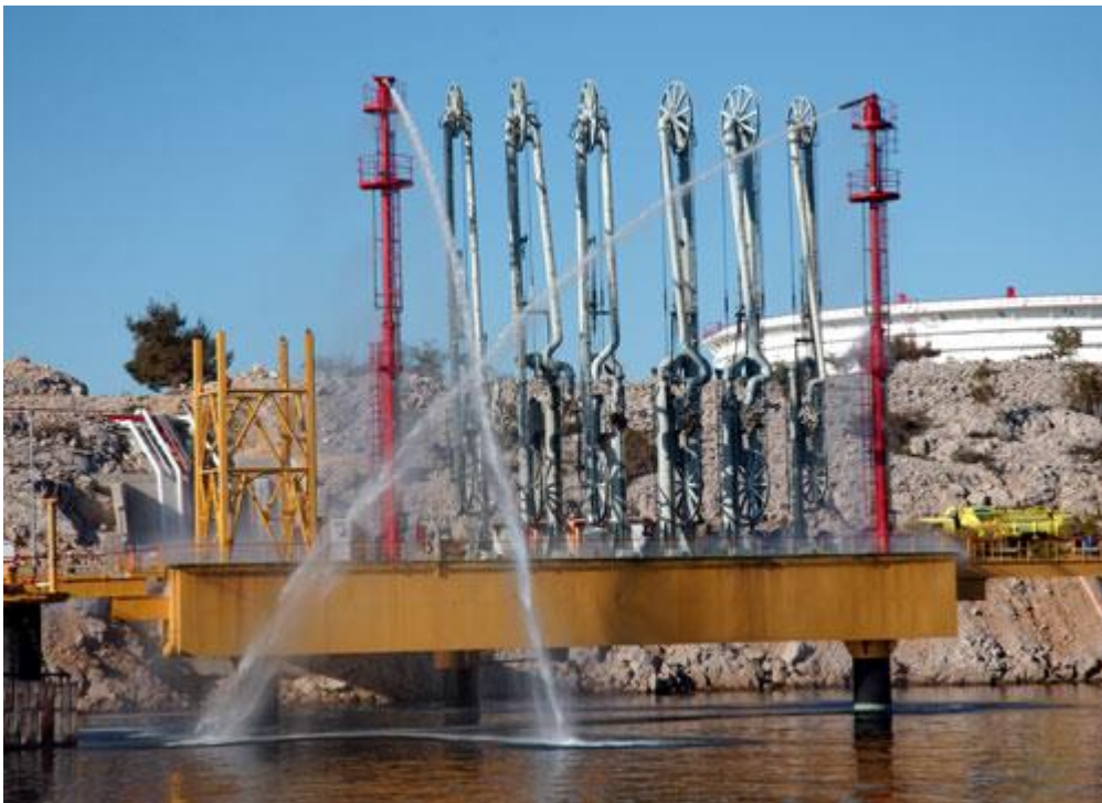
Slika 20. Vatrogasni monitori na vezu terminala u Omišlju
