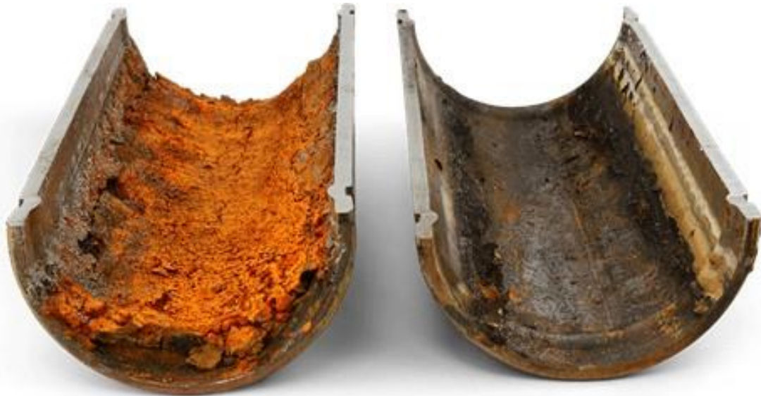
Slika 1. Primjer korozije i taloga unutar cjevovoda
