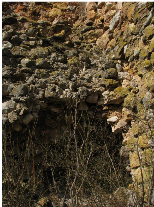
Sl. 403. Pogled s jugozapada na oštećenje pri dnu pravokutne kule
