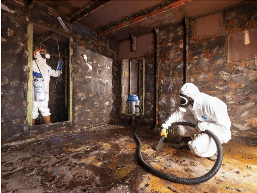
Slika 1. Pravilna sigurnosna oprema prilikom uklanjanja azbesta s broda
