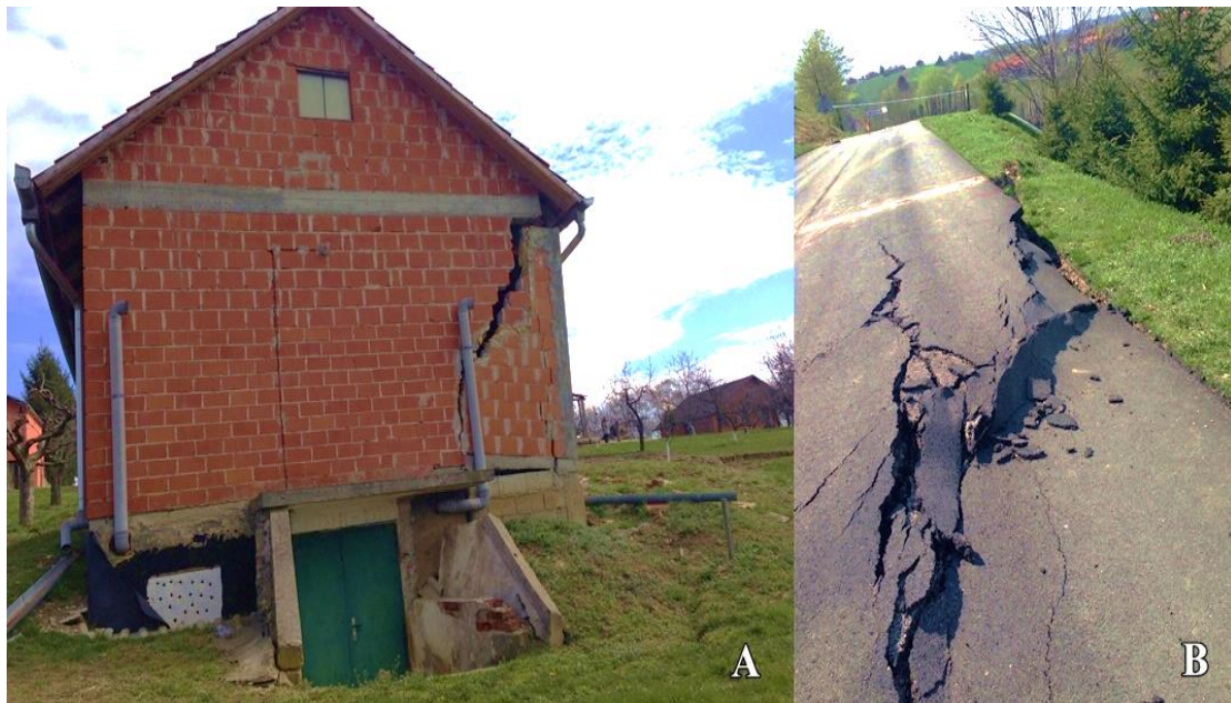
Slika 4. Primjer utjecaja klizišta na A) Građevinske objekte, B) Prometnice
