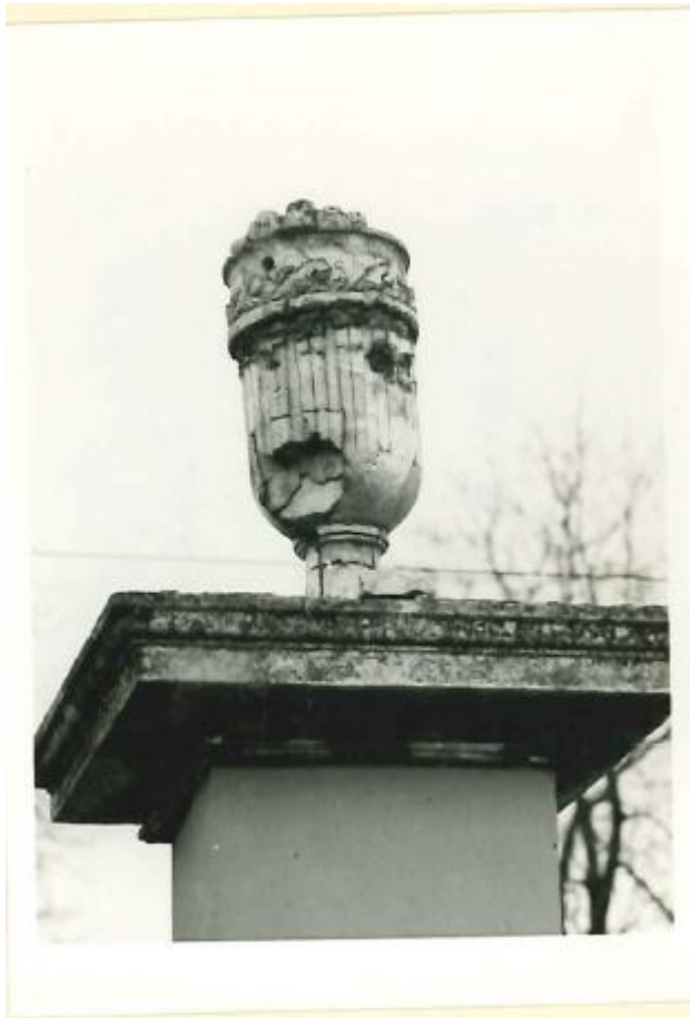
Slika 25. Oštećenja na skulpturama ograde dvorca, izvor: MK-UZKB-KOS-B 14371
