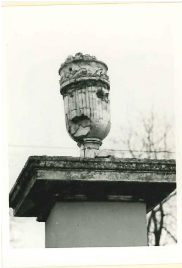
Slika 25. Oštećenja na skulpturama ograde dvorca, izvor: MK-UZKB-KOS-B 14371
