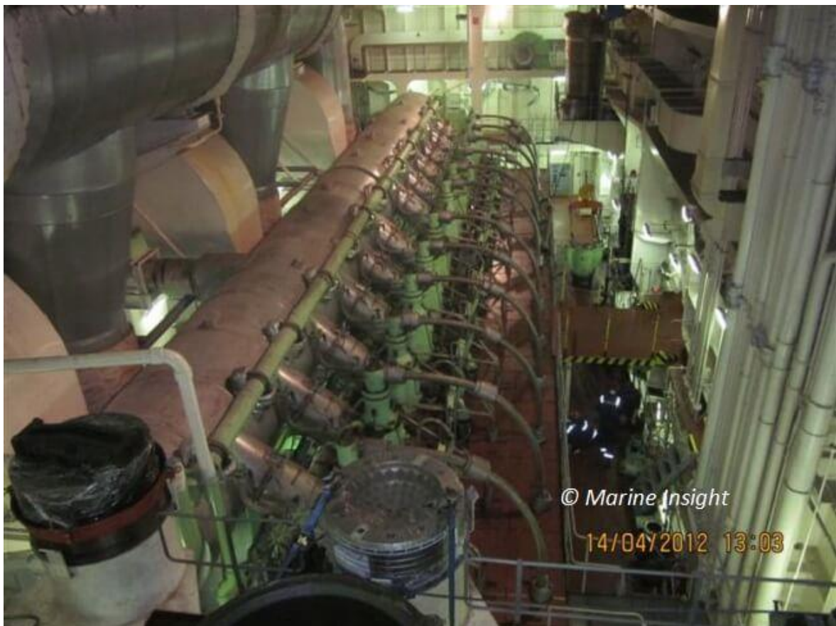
Slika 1. Strojarnica dvotaktnog motora [3]
