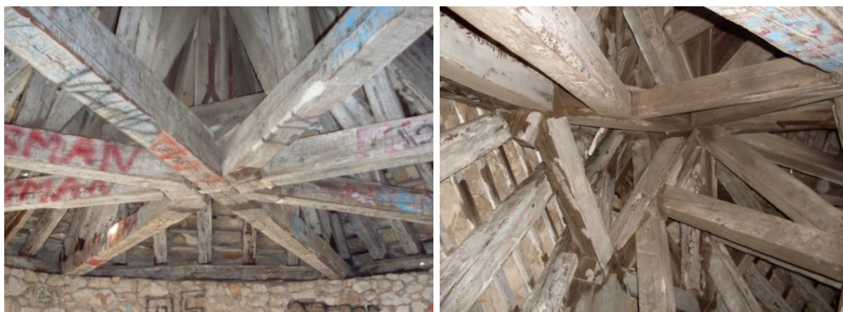
Slike 21 i 22: Današnji izgled rekonstruiranog krovišta počiteljske glavne kule (foto: N. Čuljak).
