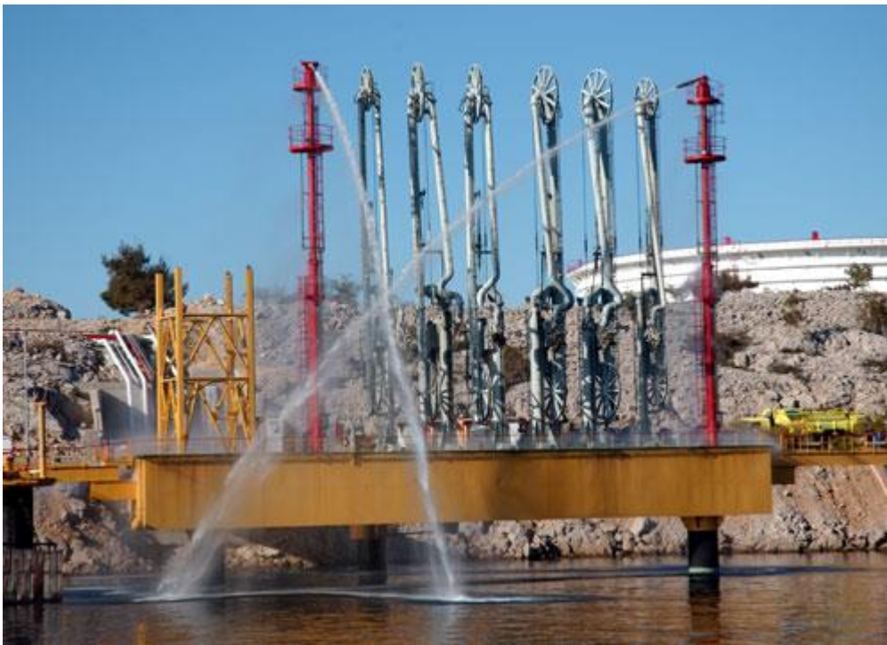
Slika 20. Vatrogasni monitori na vezu terminala u Omišlju
