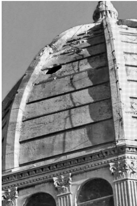
Slika 11. Oštećena kupola na katedrali u vrijeme Domovinskog rata
