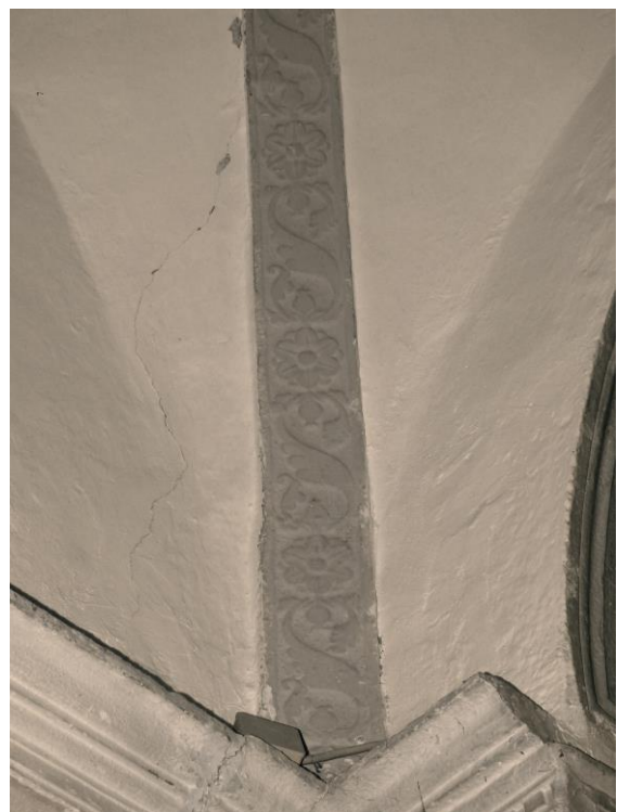
Slika 139. Kapela Benedetti, detalj svoda
