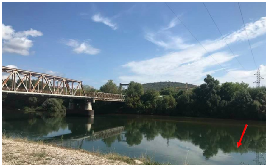
Sl. 218. Položaj mogućeg prijelaza preko Neretve sjevernije od Željezničkog mosta (foto: Ž. Pandža)
