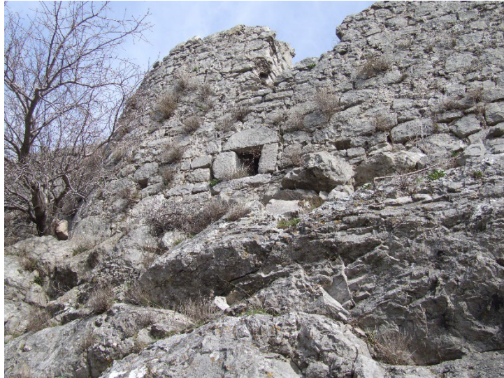
Sl. 349. Ostatak prozora na jugoistočnoj strani
