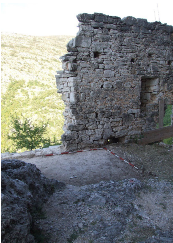
Sl. 74.a Prvi dio zida SJ 16 na zapadu Prostorije 2
