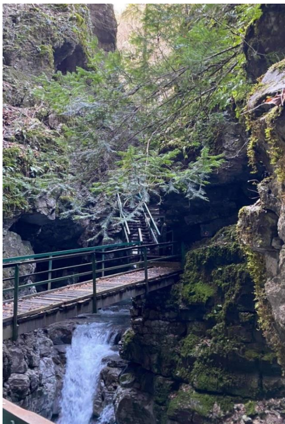
Slika 11. Pogled na srušene mostiće u Vražijem prolazu Izvor: fotografija autorice (fotografirano 28.12.2022.)
