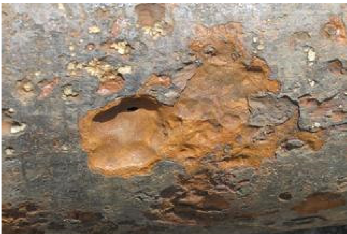
Slika 6. Točkasta ili pitting korozija [21].
