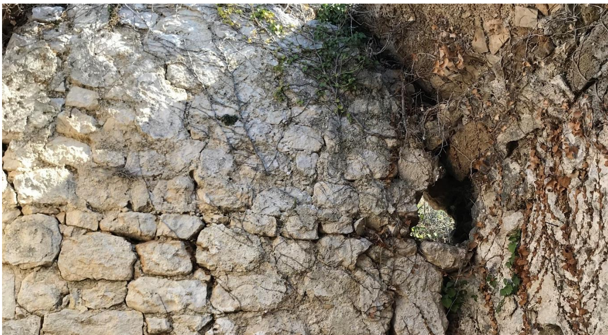
Prilog 8. Fotografija, rupa u začelnom zidu. Autor fotografije: Dora Štublin
