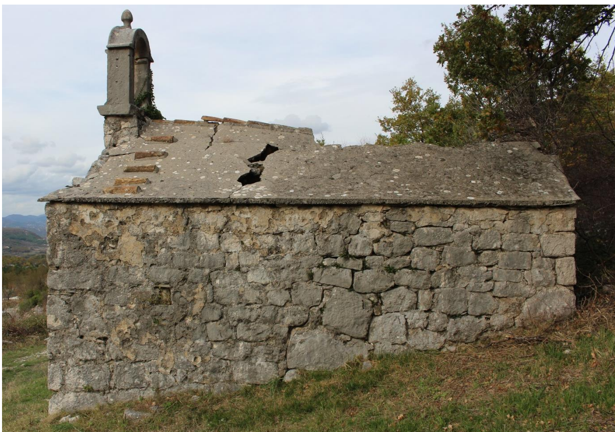
Prilog 5. Fotografija, Gospa od Zdravlja prije izvedbe radova – pogled sa jugoistoka. Autor fotografije: Izv. prof. dr. sc. Željko Miletić
