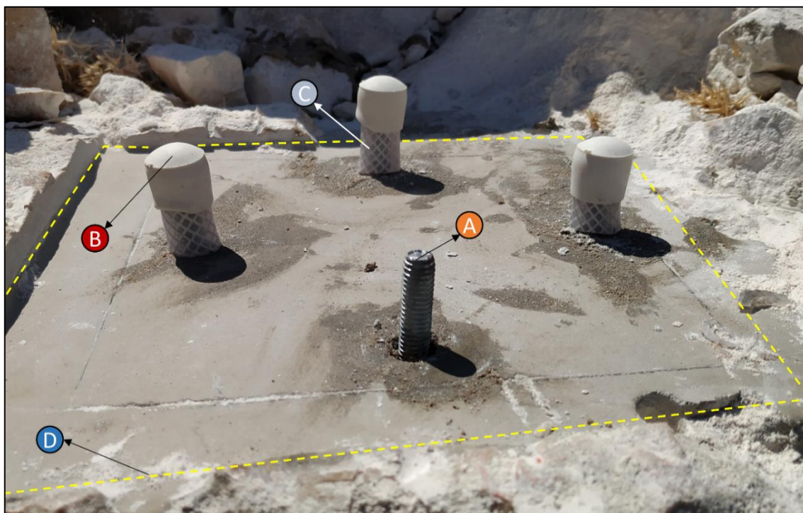
Slika 77. Zaštita sidrišnih vijaka od korozije (A – nezaštićeni vijak; B – plastična zaštitna kapica; C – plastično crijevo; D – samonivelirajući beton)
