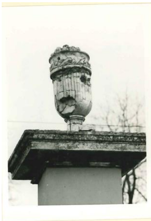
Slika 25. Oštećenja na skulpturama ograde dvorca, izvor: MK-UZKB-KOS-B 14371
