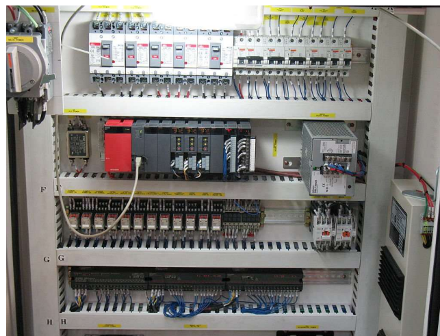
Slika 1.4.3. PLC kontrolna ploča
