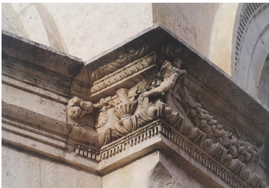
Slika 14: Detalj vijenca sa Malipierove partije , na spoju sa sjevernom apsidom
