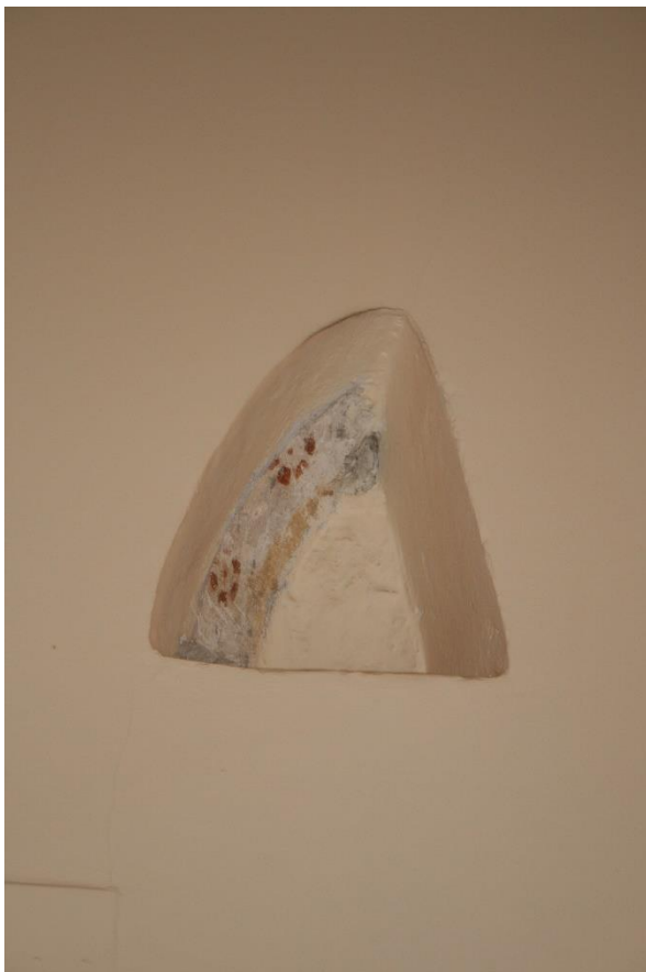
Sl. 40 Beletinec, crkva Svih Svetih, zazidani prozor (foto: Ivana Peškan)
