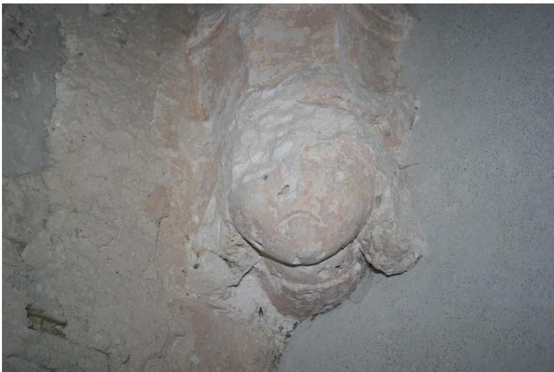
Sl. 110 Belec, crkva sv. Juraja, konzola, oštećena (foto: Vesna Pascuttini Juraga)
