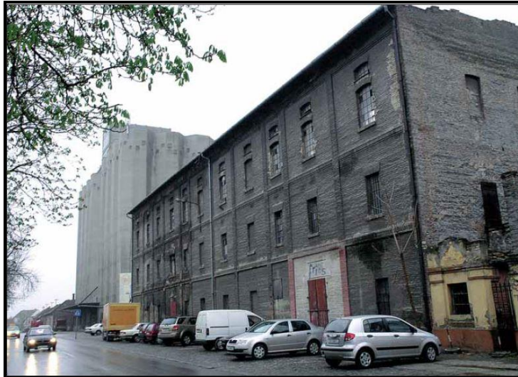
Slika 19. Ostaci nekadašnje tvornice Karolina srušeni 2005. godine
